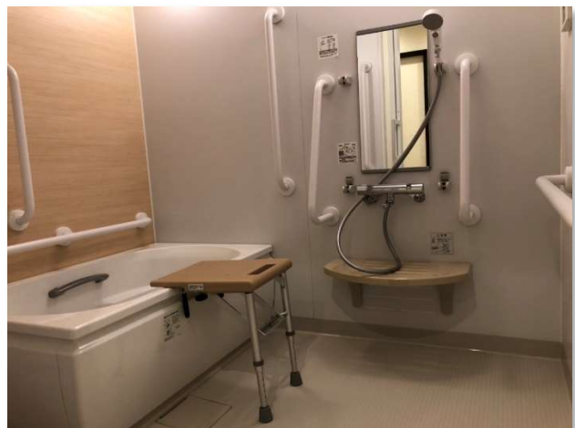
【機能性を重視した浴室】
